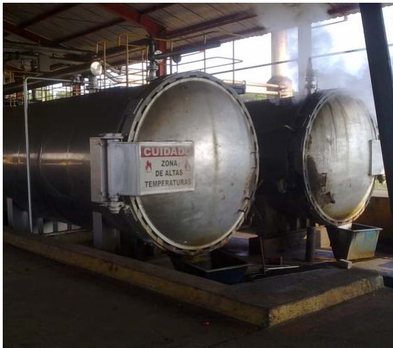
Abb. 6 (links): Dampfkessel (NEUSER 2012)
