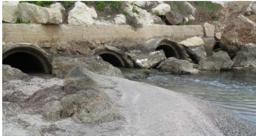
Abb. 14: Rohre als Wasserdurchlässe (SUWALA 2013)
