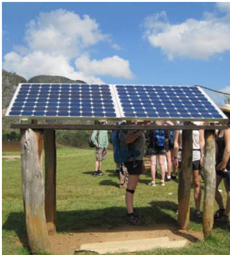
Abb. 12. Photovoltaikanlage im Tal von Viñales (SCHLINSOG 2013)
